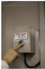
↓車内の非常ボタンを押している様子。
